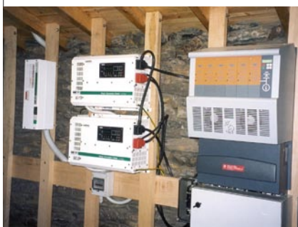
Fig. 6. Reguladores (drcha.) e inversores-cargadores (Izda.)
