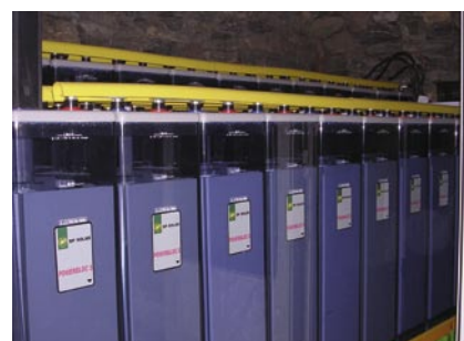
Fig. 5. Banco de baterías.
